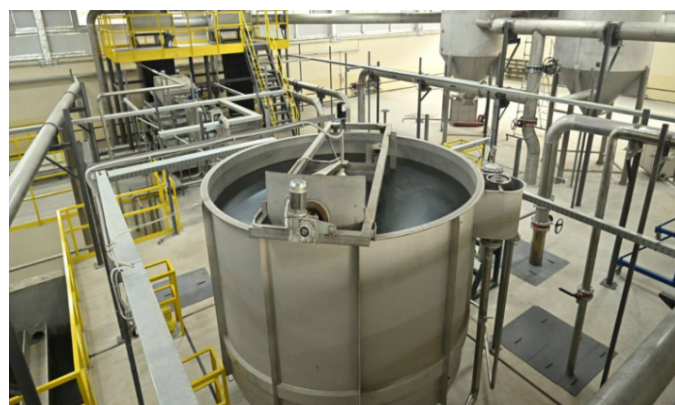
Канализационные очистные сооружения в Подпорожье
