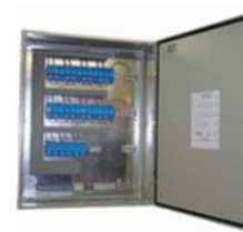
Низковольтные комплектные устройства
